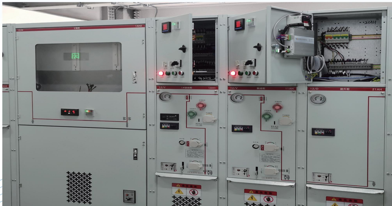
高压1号开闭站整体图
